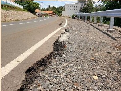
Kerusakan Bahu Jalan
