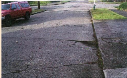
Retak Sudut (Corner Crack)
