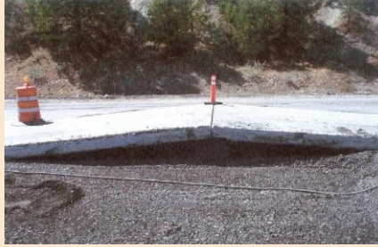
Blow up (Buckling)
